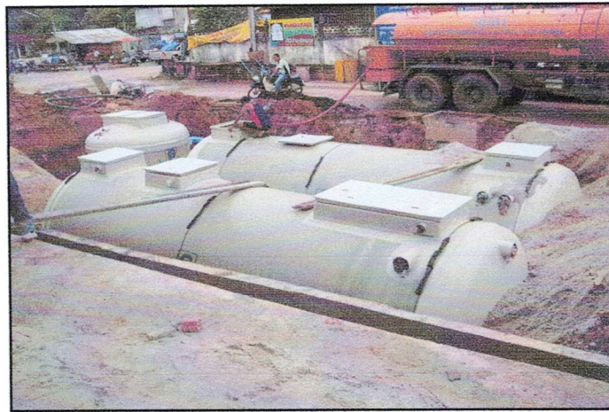
ภาพที่ ๓ : แสดงการติดตั้งระบบบำบัดน้ำเสีย แบบ Activated Sludge
