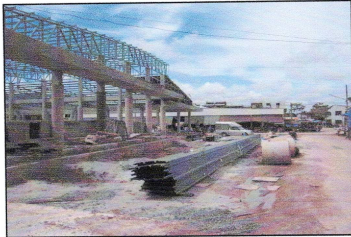
ภาพที่ ๒ : แสดงการดำเนินการปรับปรุงก่อสร้างอาคารตลาดสดเทศบาลฯ หลังใหม่
